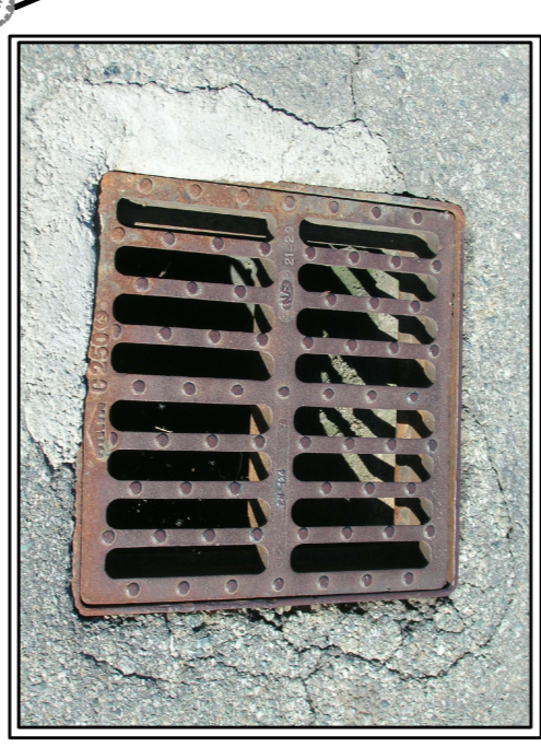
Piazzola caditoia stradale
