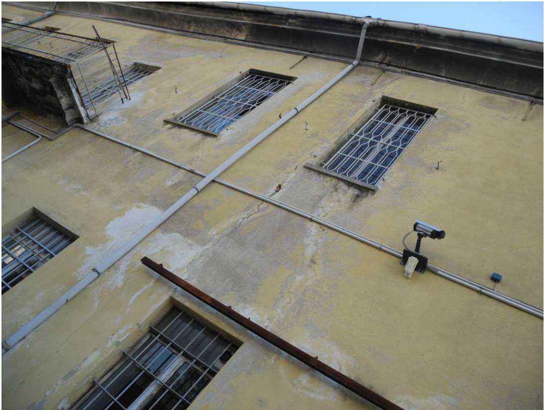
Parete verso il cortile lesionata
