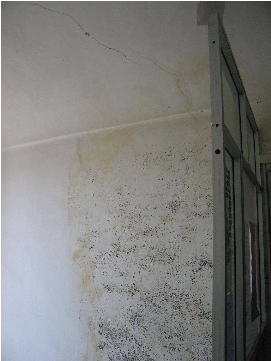
Parete e volta fessurate e macchia di umidità
