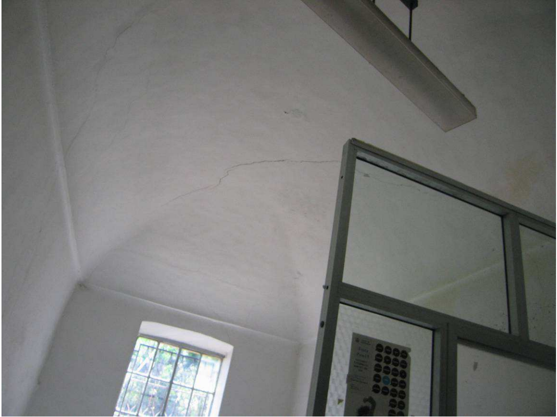
Volta fessurata su vano scala
