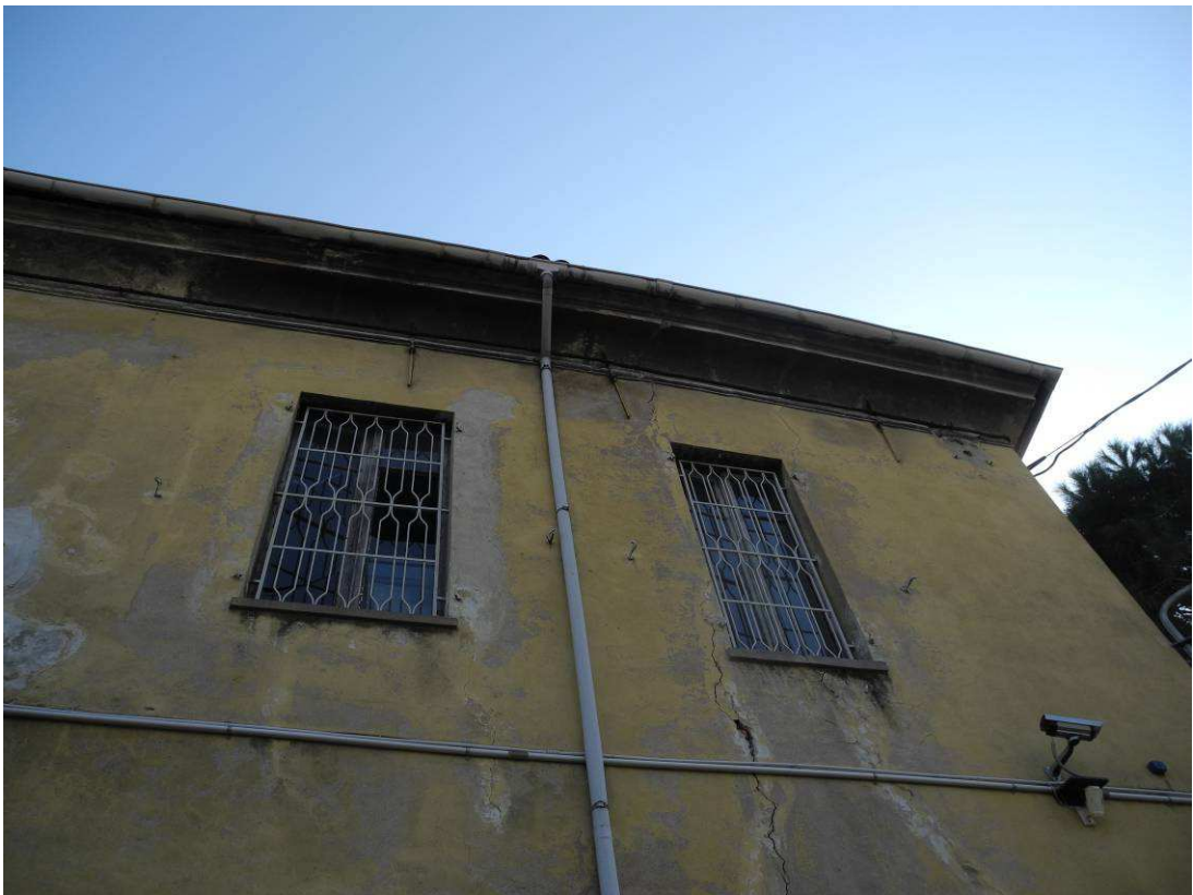
Parete verso il cortile lesionata
