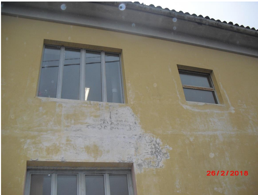
Particolare delle porzioni ammalorate del prospetto sul cortile
