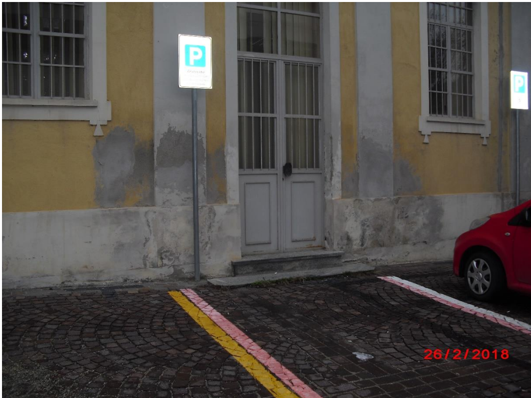
Particolare parti ammalorate sul prospetto porzione destra su Piazza Tenente Nicola
