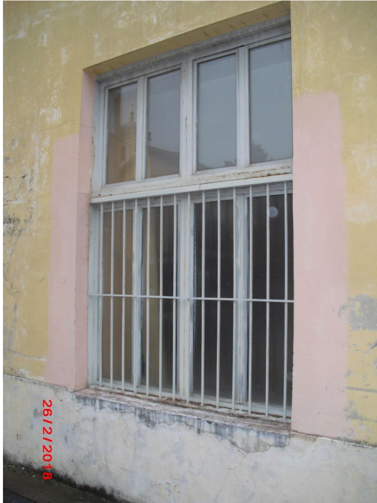
Particolare delle porzioni ammalorate del prospetto sul cortile
