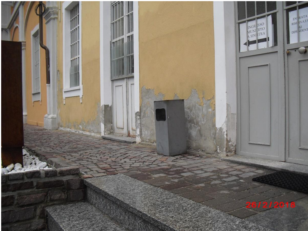
Particolare parti ammalorate sul prospetto porzione sinistra su Piazza Tenente Nicola
