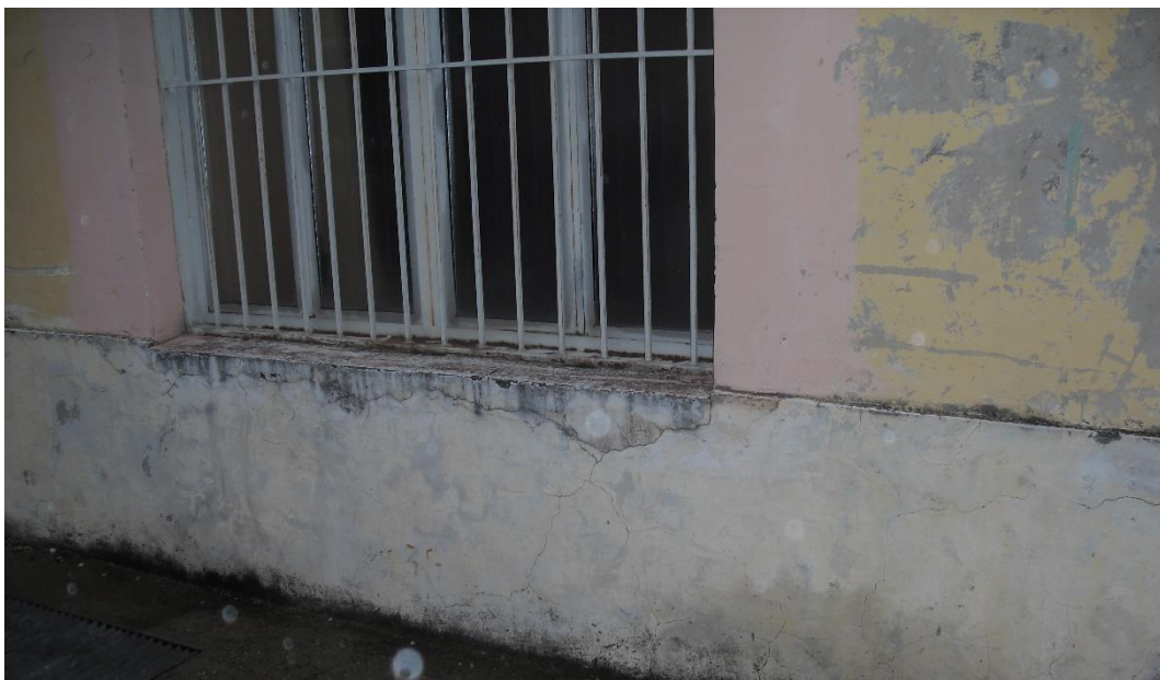
Particolare delle porzioni ammalorate del prospetto sul cortile
