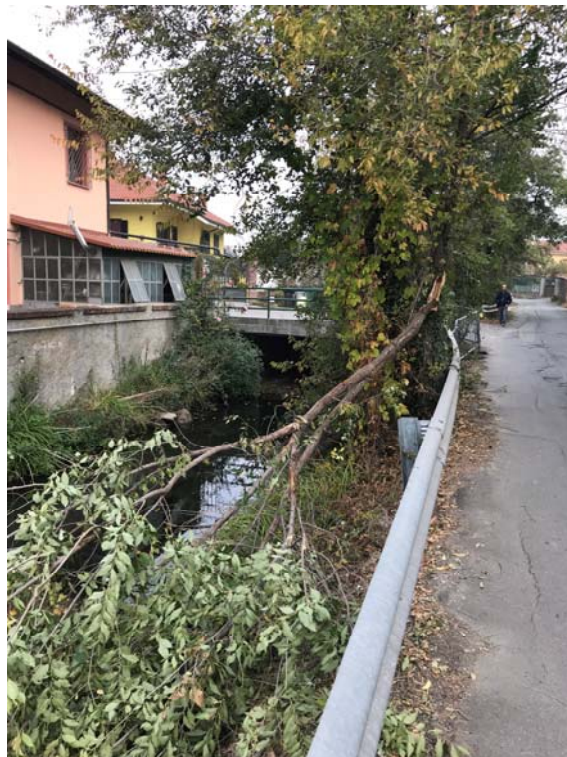
Fotografia 4 – Tratto di via Piave oggetto di cedimenti.
