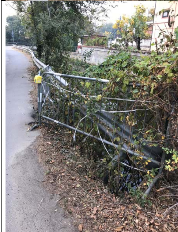
FOTO 4 – Tratto di via Piave che ha subito cedimenti durante l’ultimo evento alluvionale (novembre 2016).
