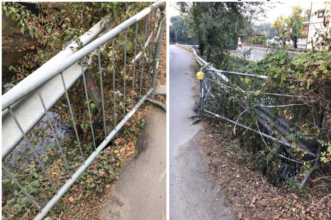
Figura 11 – Riprese fotografiche di un tratto di viabilità che ha subito locali cedimenti.
